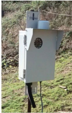
捕獲監視装置本体
